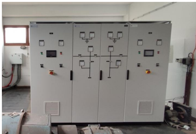
Slika 2. Novo postrojenje za napajanje elektrolizera
